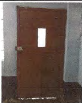
Foto 3: Sustrucción de puerta.
