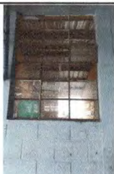
Foto 5: Sustrucción de estructura de metal de ventana
